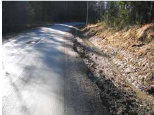
Figur 3.5. Kollapset yderrabat i et siltholdigt område. Billedet er taget det første forår efter grøfteoprensning.
