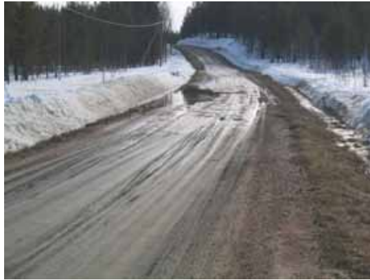
Figur 3.8. Afvandingsproblemer for lavtliggende terræn, Rd 19778, Kemijärvi, Finland.
