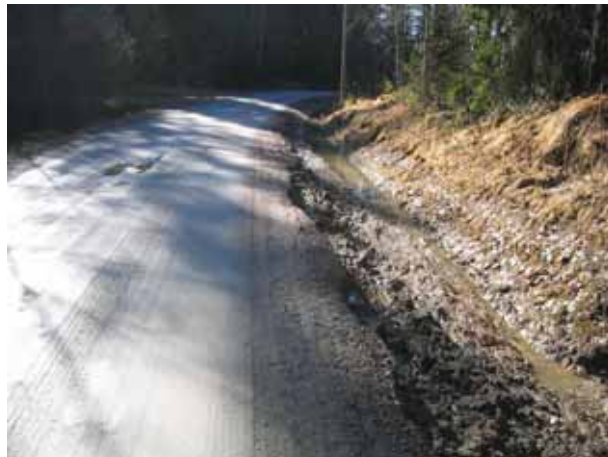
Figur 3.4. Kollapsad vägren i ett siltigt område. Kortet togs i början av våren efter en dikesrensning.
