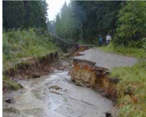
Kuva 6. Voimakkaat sateet voivat aiheuttaa merkittäviä eroosio-ongelmia vähäliikenteisillä teillä, jos kuivatusjärjestelmä ei toimi tarpeeksi hyvin.
