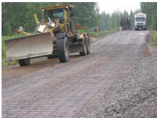
Figur 5.3. Grovkornigt stenmaterial bör användas under stål nätet för att säkra samverkan mellan stenmaterial och nät (T.Ruohomäki)
